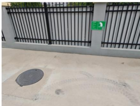
生活污水排放口及标识
