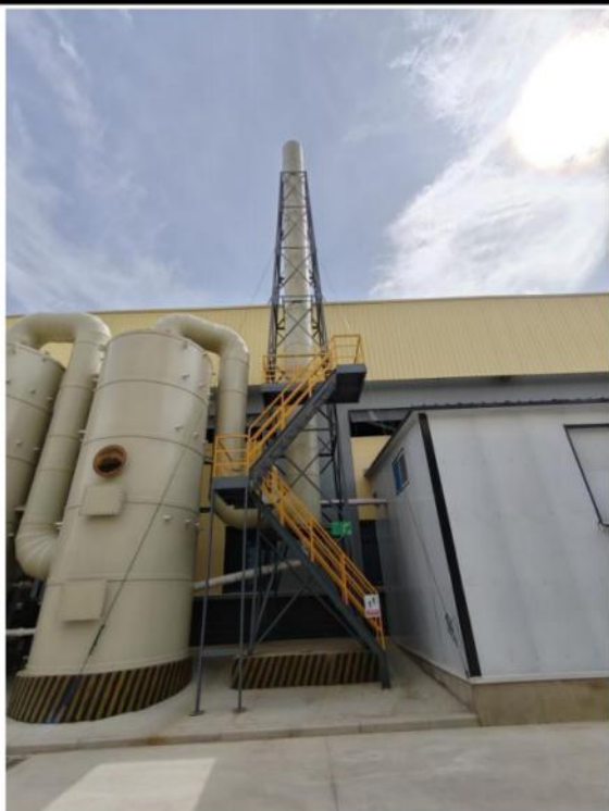
电解废气排气筒
