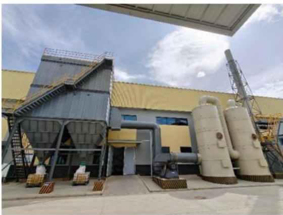
电解炉布袋除尘器及二级碱喷淋塔
