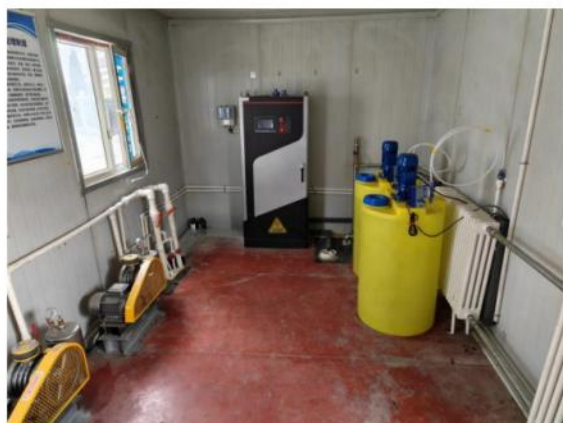
一体化污水处理装置
