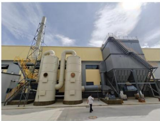
电解炉布袋除尘器及二级碱喷淋塔
